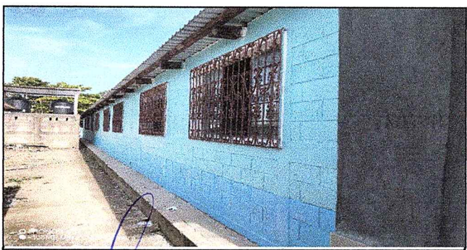
Foto 6: EL ESTABLECIMIENTO QUEDA TOTALMENTE CAMBIADA SU PINTURA EN LA PARTE INTERIOR Y EXTERIOR.
